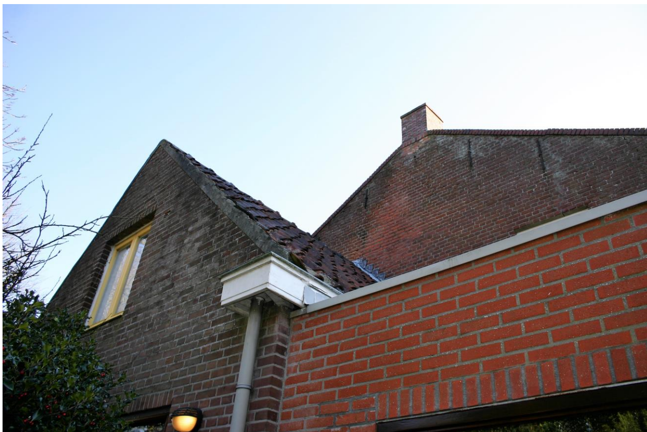
Figuur 4.2.2. De gevelpannen liggen alle in cement.
