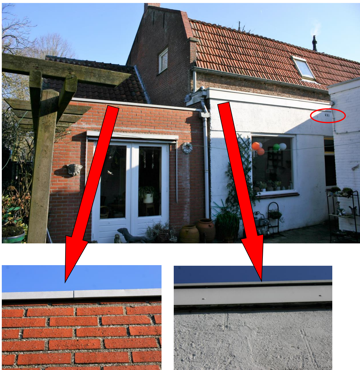
Figuur 4.2.1. De uitbouw van de woning en de eraan grenzende schuur hebben daklijsten die nauw aansluiten op de gevels. Rood omcirkeld zijn drie geïnspecteerde open stootvoegen.
