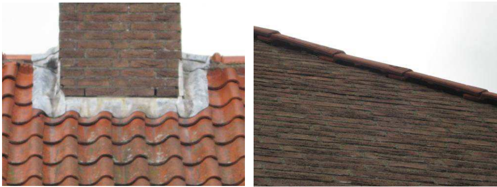
Figuur 5.4. Spouwmuurgaten en overhangende dakpannen op het pand van Keizersdijk 14 te Raamsdonksveer.
