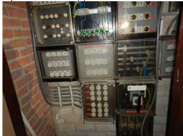
In de meterkast, geen verdachte materialen aangetroffen
