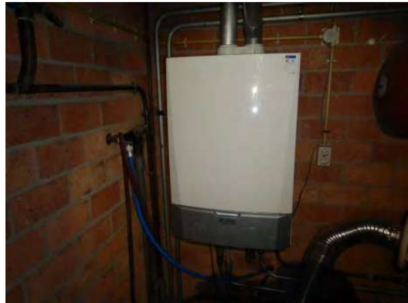
De CV-installatie is niet verdacht
