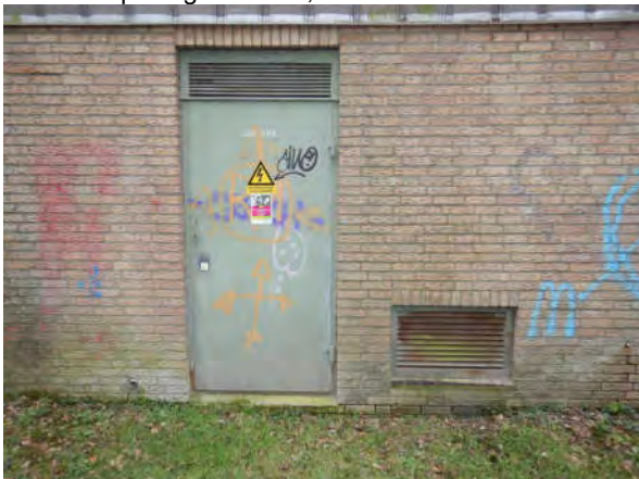
Hoogspanningsruimte niet onderzocht
