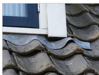
Foto 7: Openingen bij dakpannen en daklood dakkapel woning
