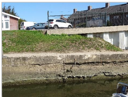
Foto 36: Scheuren in kademuur jachthaven.
