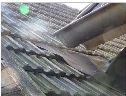
Foto 5: Openingen bij daklood dakkapel woning.
