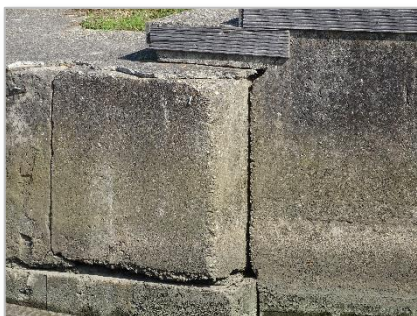
Foto 30: Scheuren in kademuur jachthaven.
