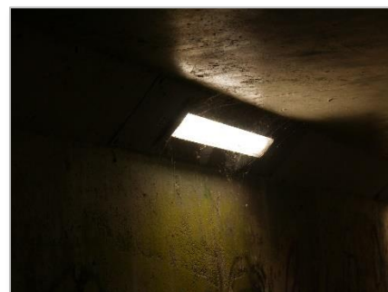
Verlichting fietstunnel Foto 62
