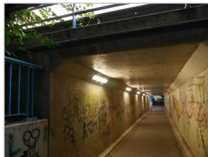
Verlichting fietstunnel Foto 61
