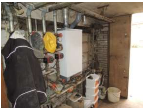
Foto 2: In de schuren is een CV-ketel aangetroffen van het merk Intergas type solo HR28 uit het bouwjaar 2012.
