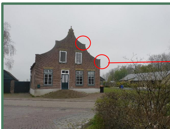
Mogelijke nestplaats op muurplaat
