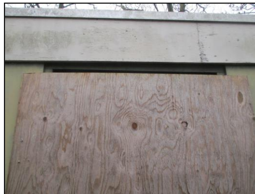
Foto 10: Gat boven dichtgetimmerde deur
