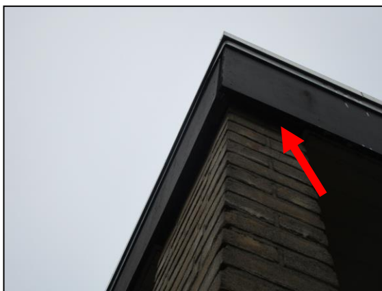
Foto 5: Opening achter daklijst
