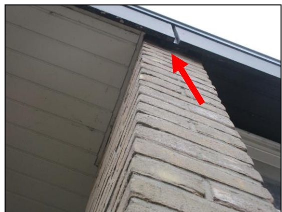
Foto 8: Opening achter daklijst
