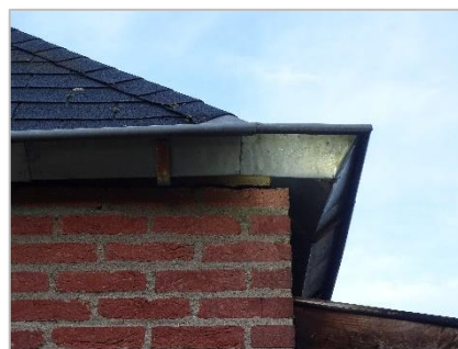
Foto 28: Openingen bij dakrand/dakgoot.
