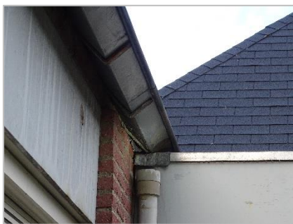
Foto 29: Openingen bij dakrand/dakgoot.
