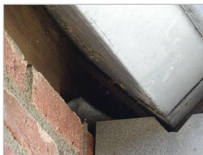
Foto 33: Openingen bij dakrand/dakgoot.
