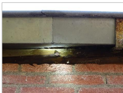
Foto 32: Openingen bij dakrand/dakgoot.
