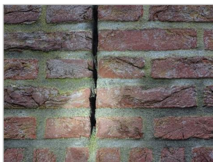
Foto 27: Openingen bij stootvoeg.
