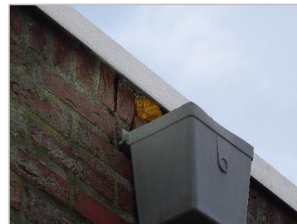
Foto 25: Openingen bij dakrand/aansluiting regenpijp.
