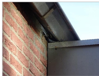
Foto 31: Openingen bij dakrand/dakgoot.
