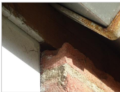
Foto 30: Openingen bij dakrand/dakgoot.
