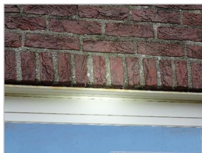
Foto 24: Openingen bij raamkozijn.
