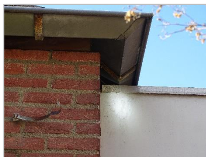
Foto 34: Openingen bij dakrand/dakgoot.
