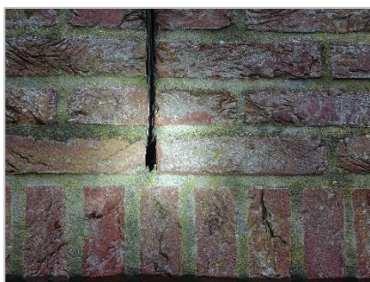
Foto 26: Openingen bij stootvoeg.
