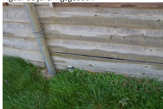
Figuur 59 opening in jureringsgebouw
