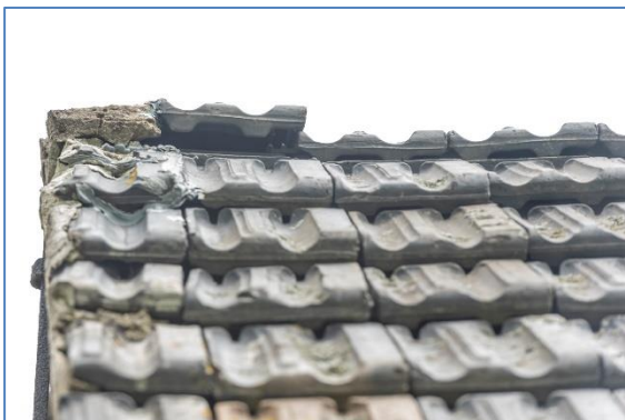
Figuur 03: opstaande dakpannen..
