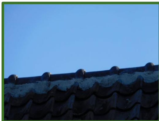
Nok van het dak, dichtgesmeerd met cement
