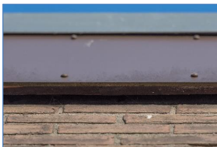
Figuur 04: openingen tussen boeiboord en muur
