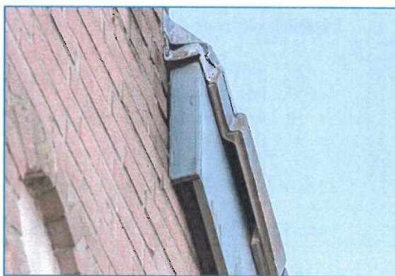
Figuur 09: Openingen tot dak middels openstaande loodslabben.
