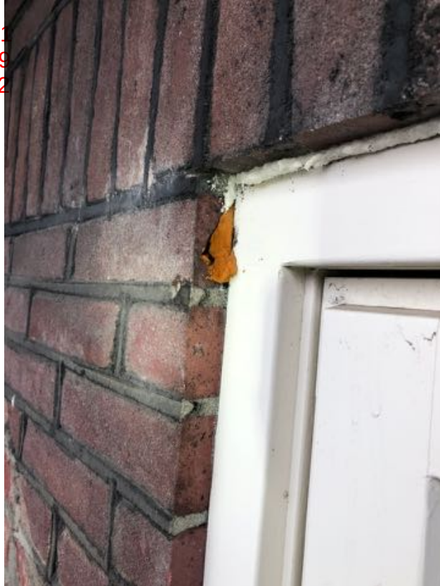
Afbeelding 5: kieren zijn afgedicht met Purschuim tegen tocht. Dit is al eerder gebeurd, te zien aan de oranje kleur van het Purschuim. Het lichte schuim boven het kozijn is van veel recentere datum.
