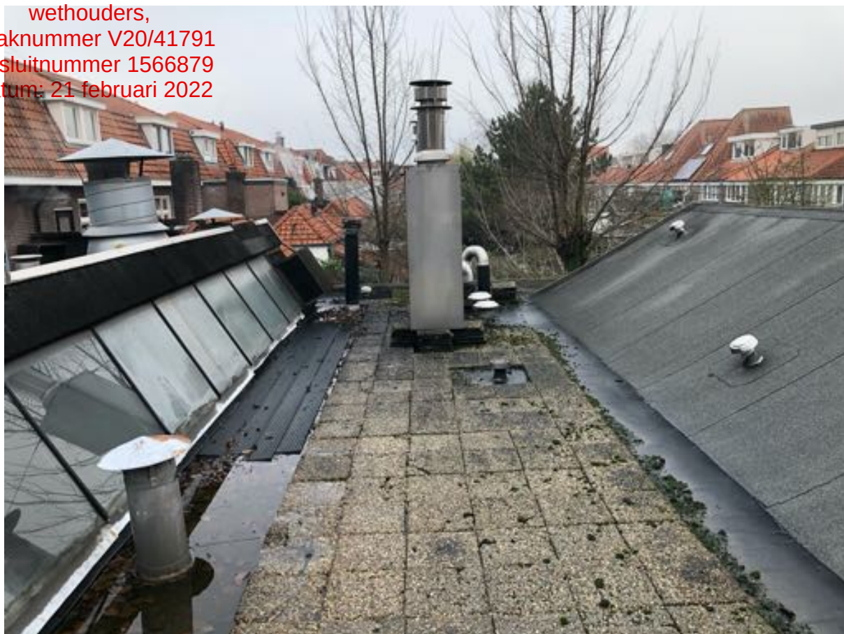
Afbeelding 2: een van de dakdoorvoeren die warmte genereren.
