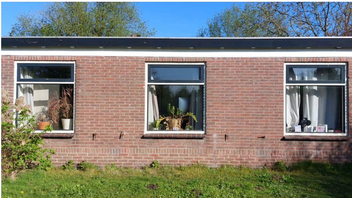
Figuur 4.4.3. Open stootvoegen en ventilatiesleuven zijn afwezig.
