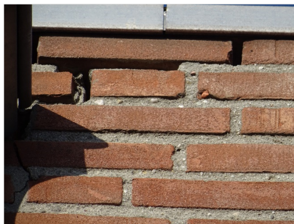
Figuur 5.2 Gaten in de muur en spleet onder dakrand die toegang tot spouwmuur verleent.
