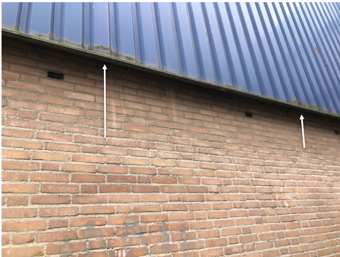
Figuur 5a: Halve spouwmuur met exclusie patches. De toegang via de achterzijde van de staalplaten is onmogelijk door de aangebrachte metalen constructie aan zowel de onder als bovenzijde. Zie onderstaande figuren.
