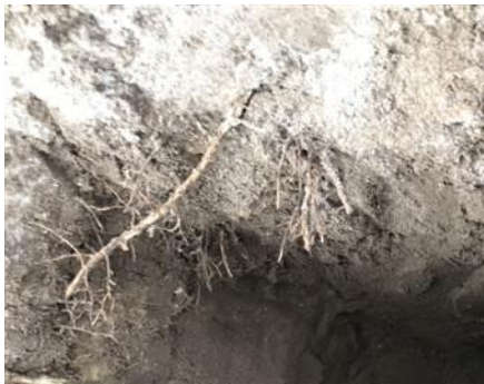
Afbeelding 6: haarbeworteling onder trottoirtegels bij boom 8
