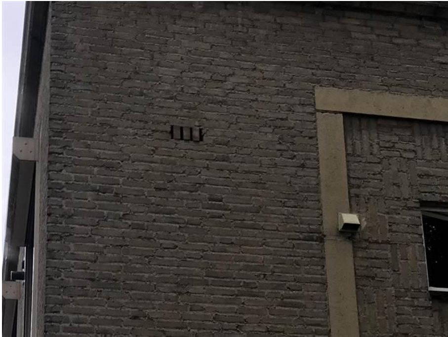
Afbeelding 8: Open-stootvoegen in het nabijgelegen gebouw aan de Jan van Riebeecklaan 2-8
