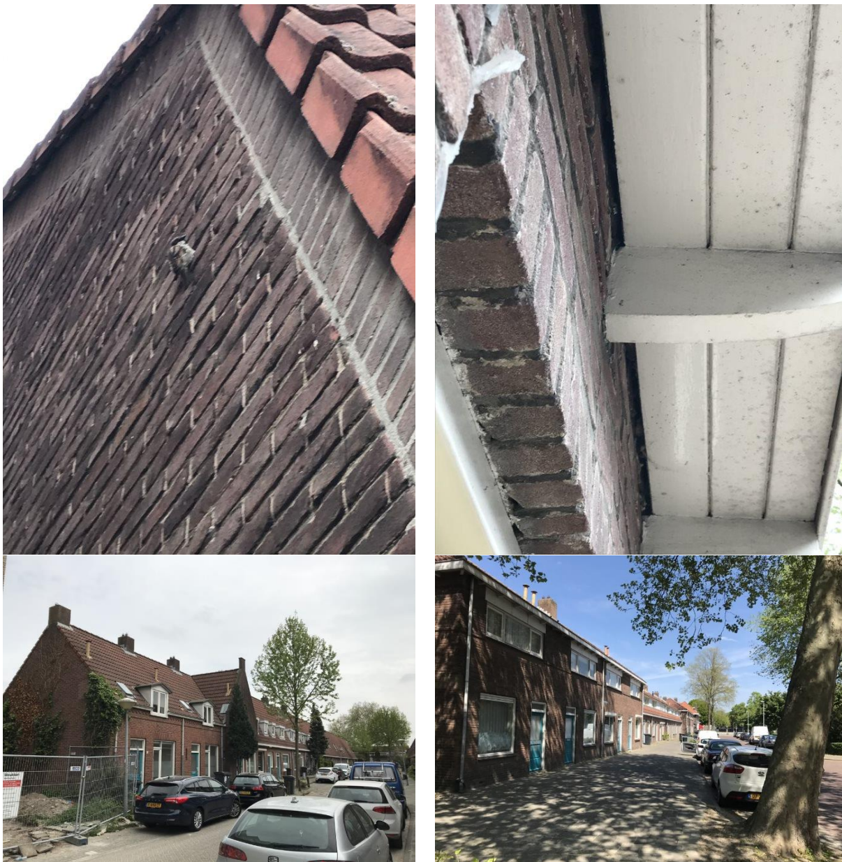
Figuur 4 Met de klok mee: 1) huismus op gebouw in plangebied, ook zijn de voor vleermuizen en broedvogels toegankelijke randpannen zichtbaar; 2) voor vleermuizen toegankelijke dakbekisting; 3) Zicht op Verwerstraat met op de voorgrond de hogere woningen binnen het plangebied. Op de achtergrond is de valse acacia te zien waarin een ekster nest zit; 4) zicht op Wassenaarstraat waarin ook dakkapellen zichtbaar zijn (toegankelijk voor vleermuizen).
