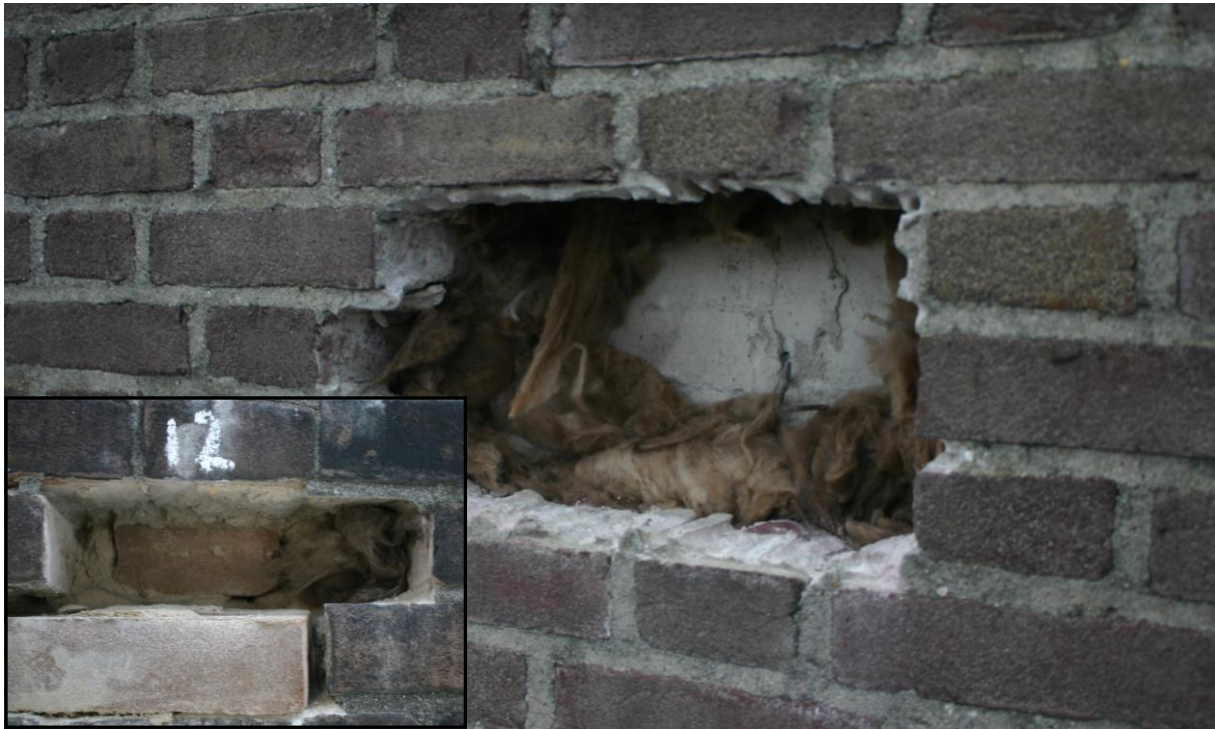
Figuur 4.2.2. De gevel is op verschillende plaatsen geopend. Hier is duidelijk te zien dat de glaswol strak tegen het buitenblad aanligt, waardoor er geen plek is voor vleermuizen om in de spouw te kruipen.
