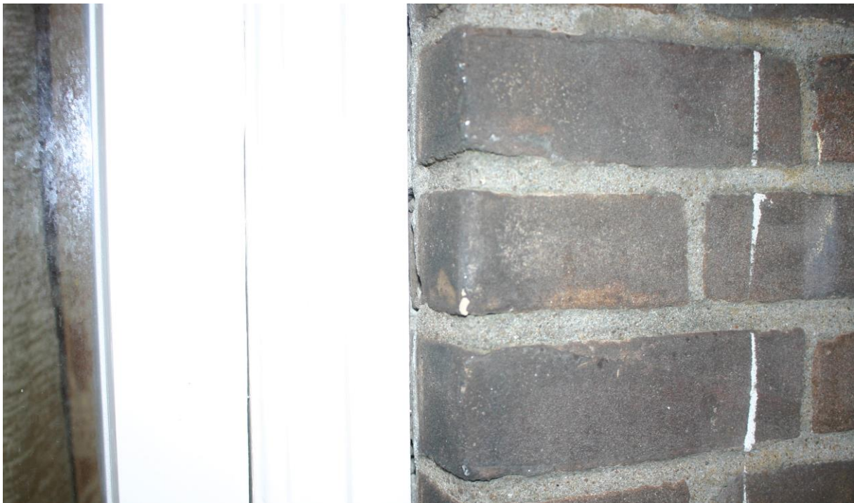
Figuur 4.2.3. Op enkele plekken bevinden zich kieren tussen de (raam)kozijnen en de gevel.
