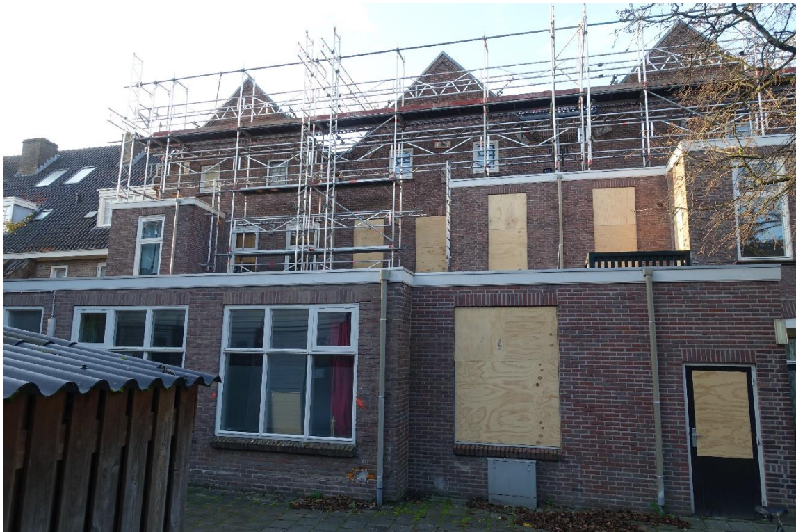
De diverse uitbouwen aan de linkerzijde van de achtergevel. Geheel links op de verdieping een oorspronkelijke (keuken)uitbouw. De uitbouwen doen afbreuk aan de oorspronkelijke opzet.
