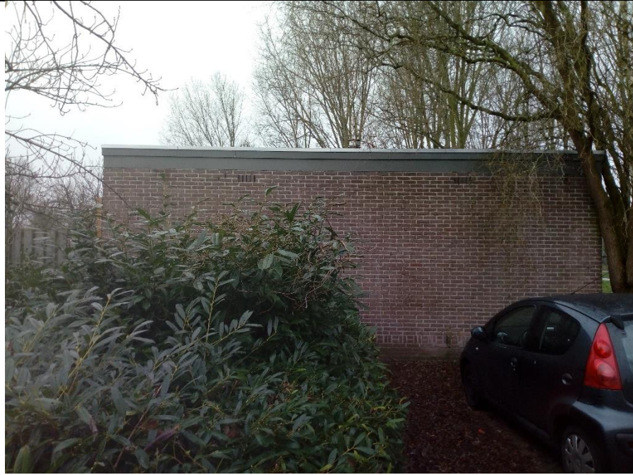
Foto van zijgevel met stootvoegen in de gevel. Ook daktrim is te zien. Deze vormen mogelijke openingen voor vleermuizen en vogels.
