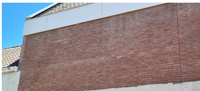
Figuur 11: Open stootvoegen in de gevel van een aangrenzend gebouw tegen de oostelijke erfgrens
