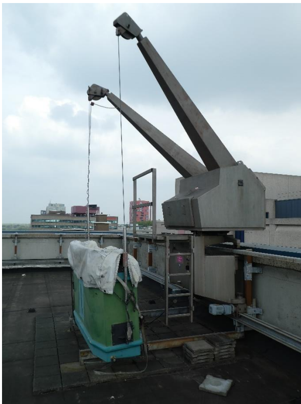
De glazenwasinstallatie op het dak van de hoogbouw. Deze installatie is in onbruik geraakt.
