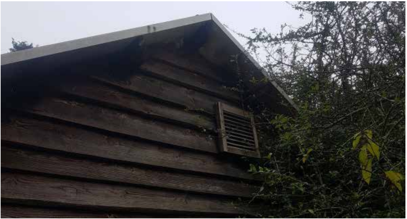
Foto 2: De schuur in het plangebied met een opening in het houtwerk.
