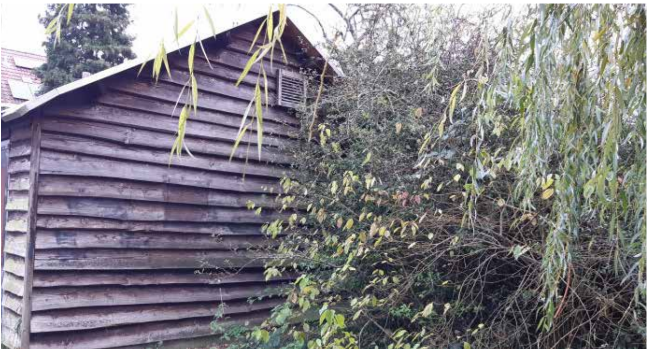
Foto 1: De schuur in het plangebied met een opening in het houtwerk.
