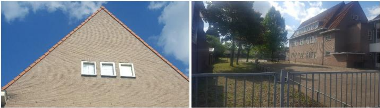
Figuur 3. Links: aanwezige stootvoegen en geveldakpannen aan de kopse kant van nr. 150. Rechts: omgeving ten oosten van nr. 150.
