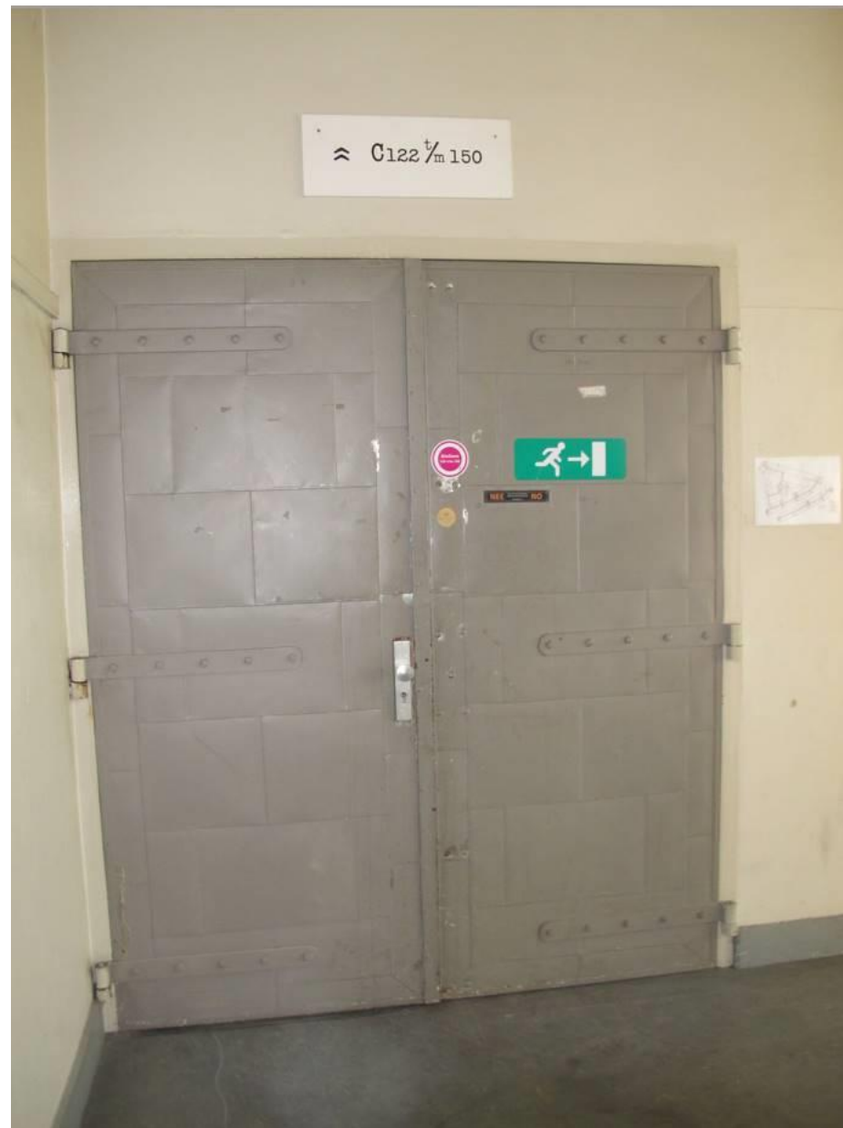
Brandwerend beklede deuren tussen de gangen en de trappenhuisen
