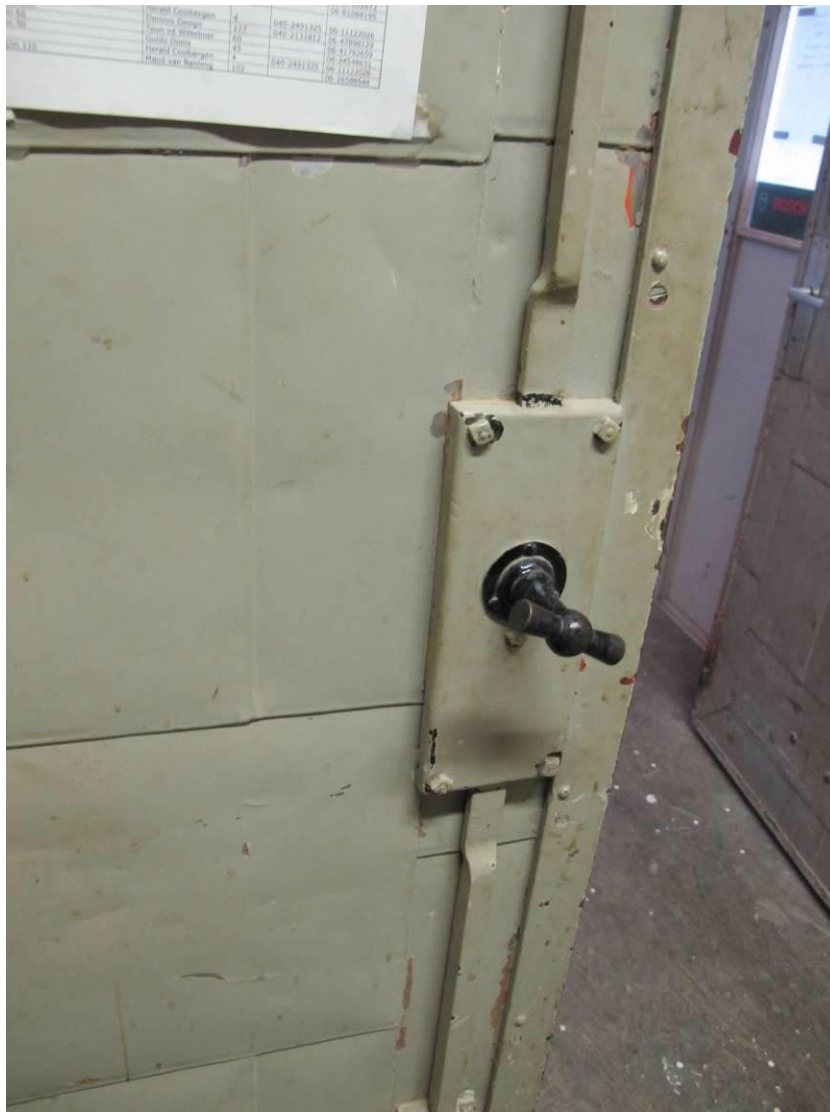
Sluiting op brandwerend beklede deur
