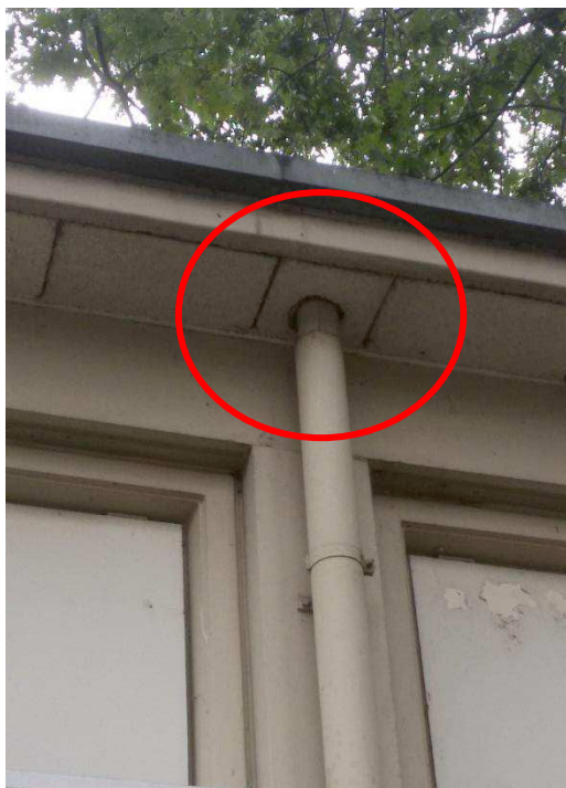
Foto 3: Ruimte tussen de regenpijp en stenen aan het gebouw Paviljoen. Op verschillende plekken waren deze ruimtes aanwezig. Deze kunnen mogelijk dienst doen als verblijfplaats voor vleermuizen.
