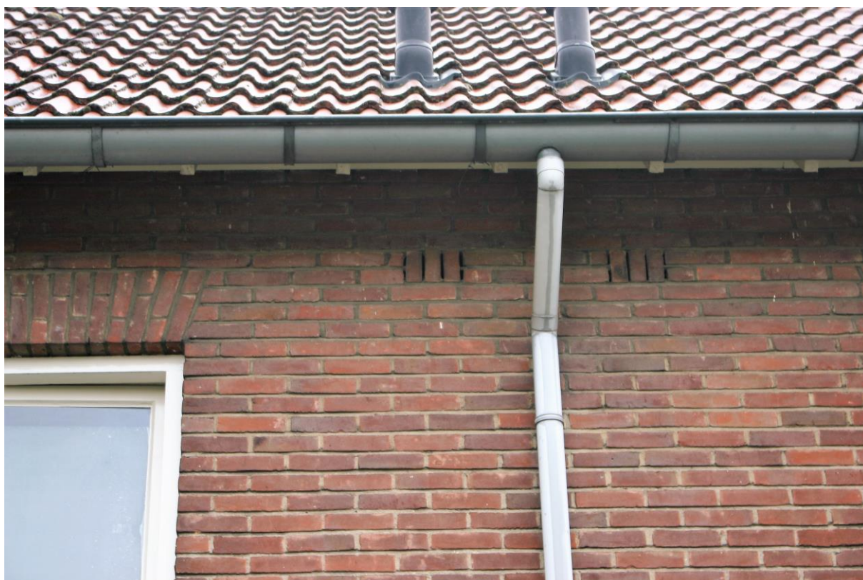
Figuur 4.2.2. In de woningen met twee bouwlagen bevinden zich ventilatiesleuven op de eerste verdieping.
