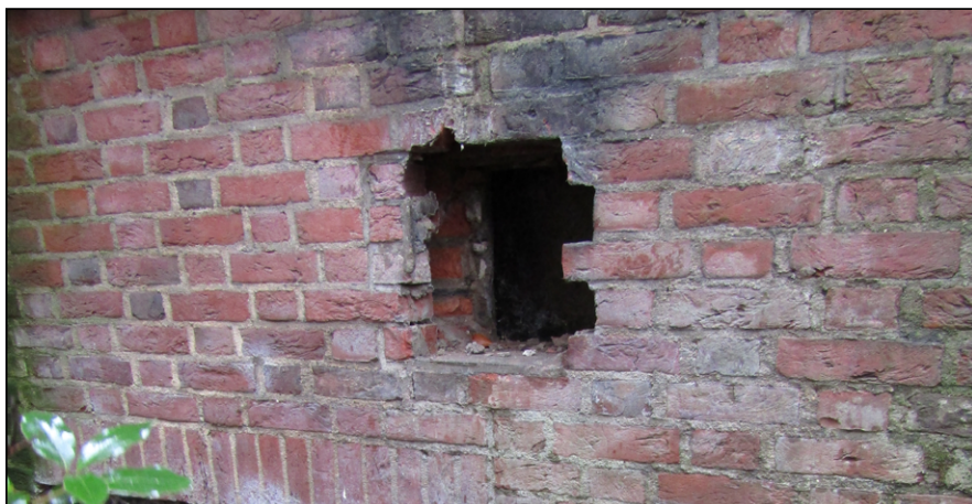
Figuur: op sommige plaatsen zijn openingen aanwezig waardoor de spouwmuur toegankelijk is voor vleermuizen of steenmarter.
