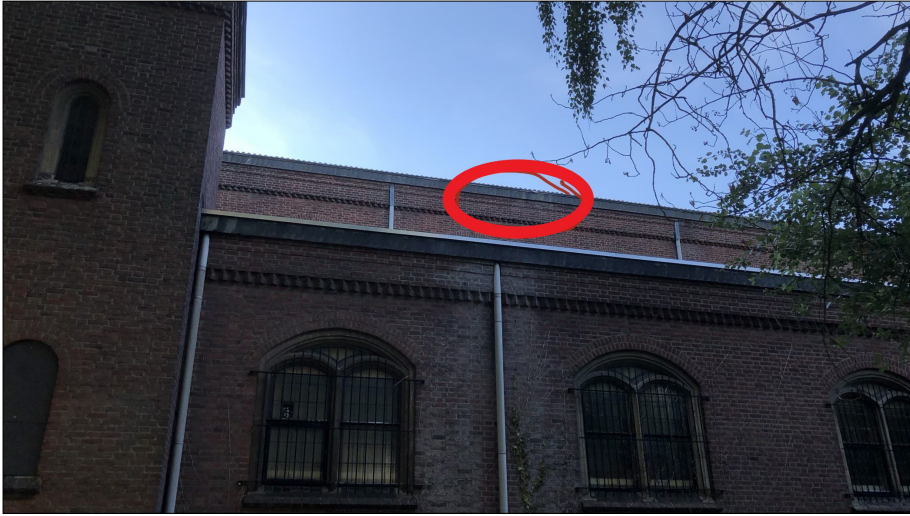
Figuur: Invliegopening van minstens drie gewone dwergvleermuizen met rode cirkel aangegeven. Het betreft de zomerverblijfplaats aan de zuidzijde van het gebouw. De verblijfplaats bevindt zich in de dakrand van de tweede verdieping.
