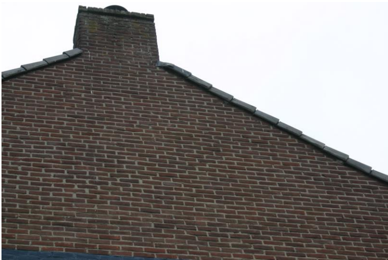
Figuur 4.5.3. De gevelpannen op de woningen aan de Kronehoefstraat liggen niet in de specie.
