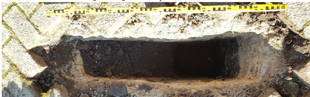
Foto 3. Geen beworteling aanwezig onder de rijbaan, GPO 2
