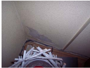
Vochtplekken in bouwmuur bij voorgevel
