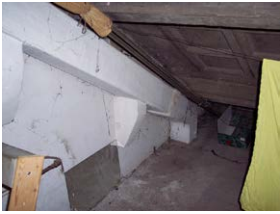
Asbestcement ontluichtingskanaal (type C)
