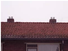
Ligging dakpannen rommelig en vervuiling (type C Struyckenstraat)
