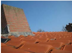
Mosvorming bovenaan vernieuwde schoorsteen, dakpannen niet goed aangesloten
