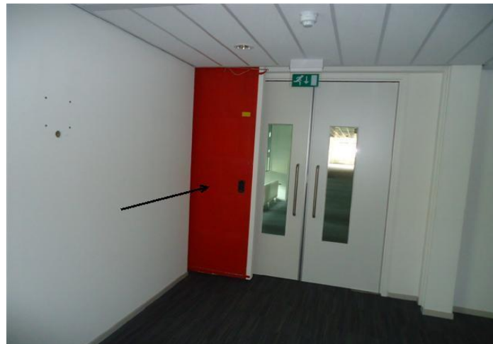
Branddeur in de gang
