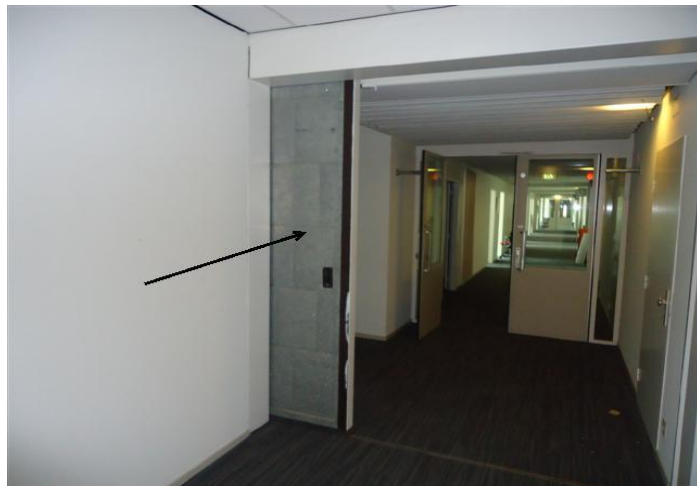
Branddeur in de gang
