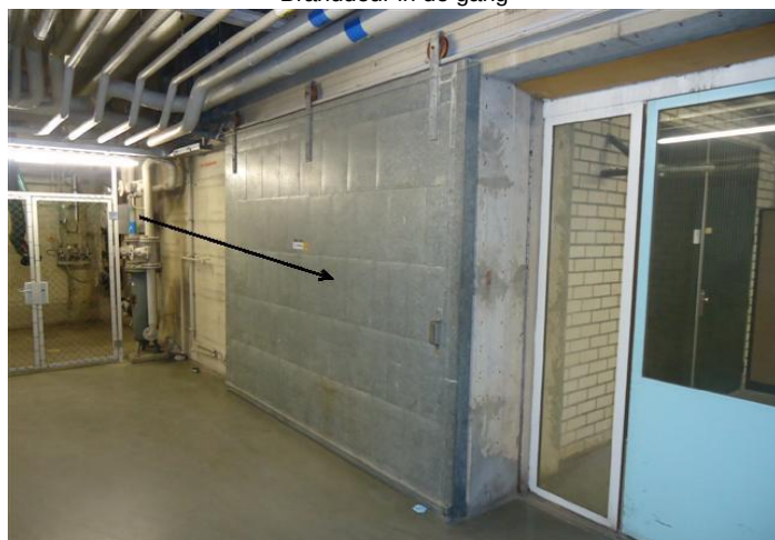
Branddeur in het souterrain
