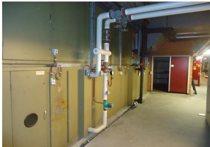
Pakkingen tussen de flenzen in technische ruimte dakopbouw
