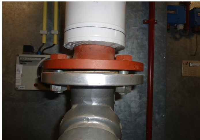
Pakkingen in de technische ruimte
