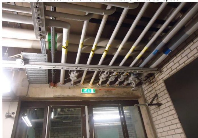
Pakkingen tussen de flenzen in technische ruimte souterrain
