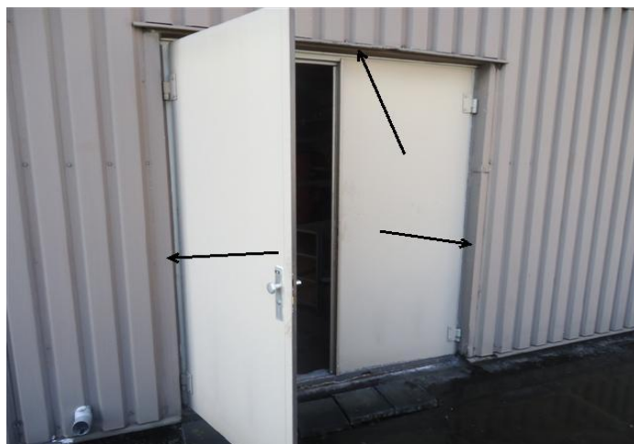
Waarschijnlijk asbesthoudende coating tegen hoekprofielen rondom deur.
