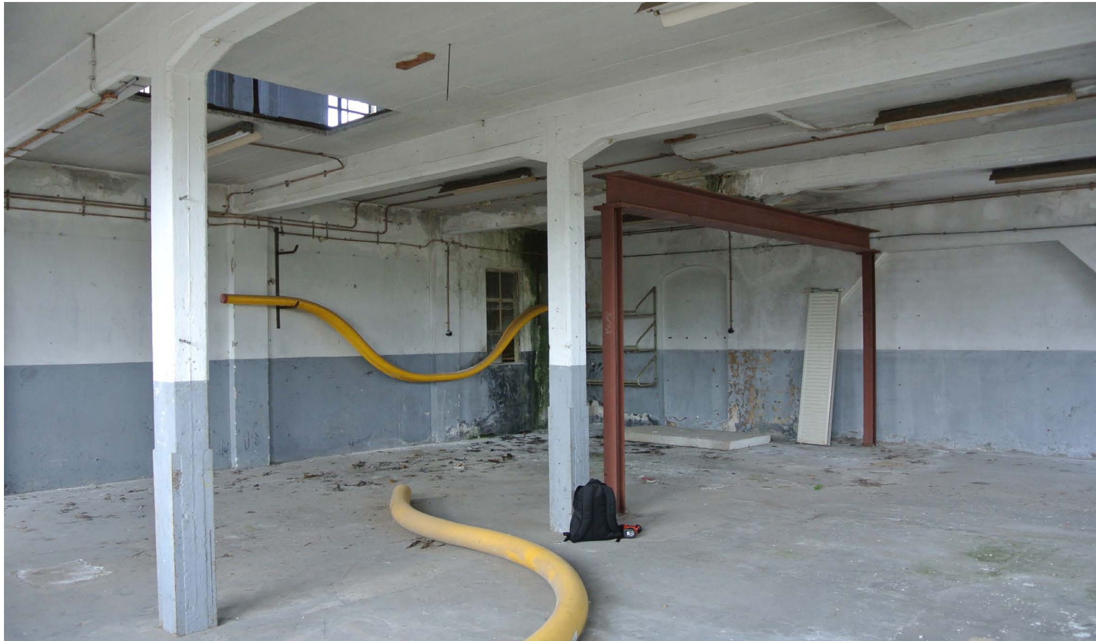
condensatieruimte. stalen hulpconstructie ter vervanging kolom. dichtgemaakte openingen naar ruimte locomobiel. verdiepingsvloer slechte technische kwaliteit
