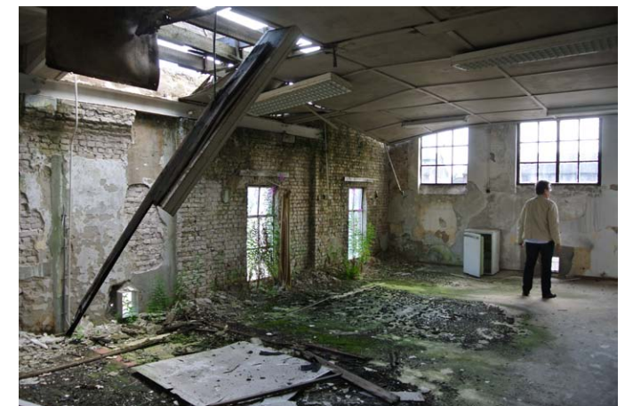
turbineruimte. verregaande aantasting/ ontbrekend dak. aantasting vloer en wanden. historisch metselwerk en kozijnen.
