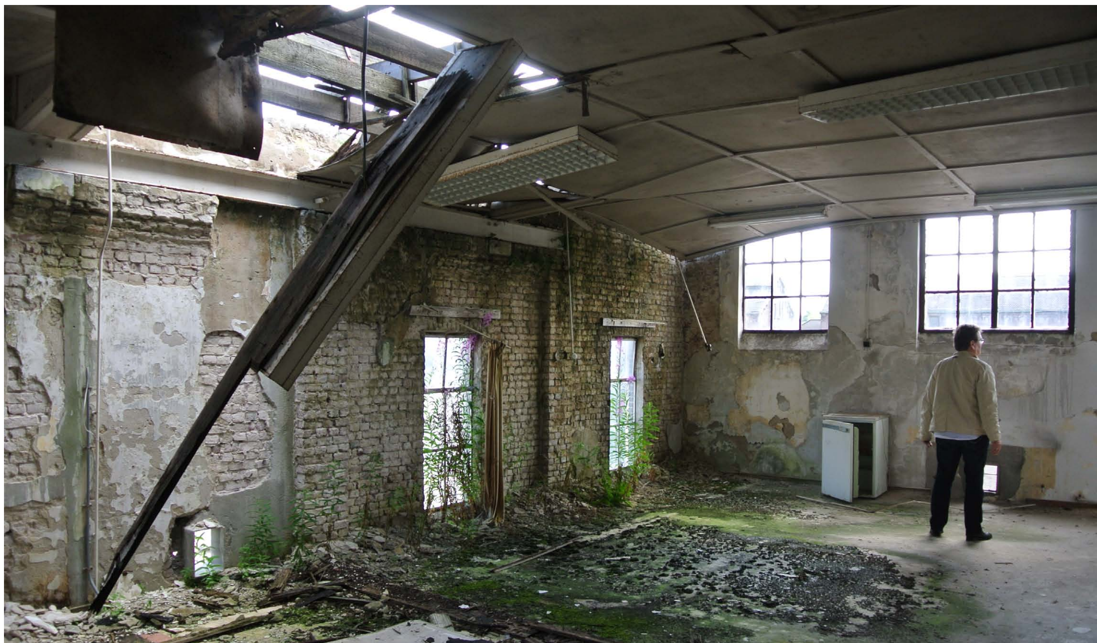
turbineruimte. verregaande aantasting/ ontbrekend dak. aantasting vloer en wanden. historisch metselwerk en kozijnen.
