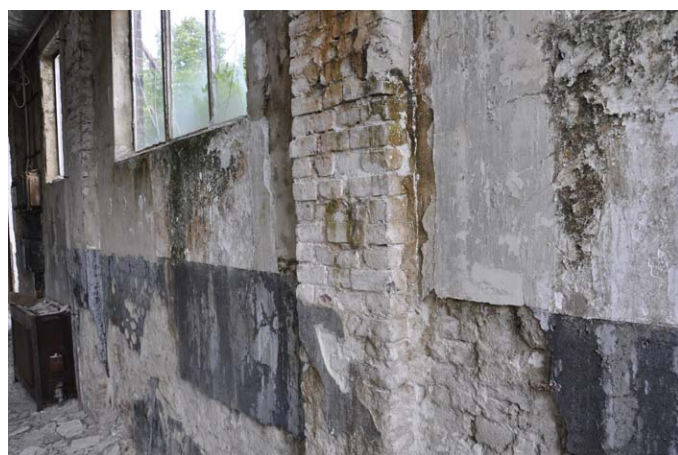
aantasting gevel binnenzijde
