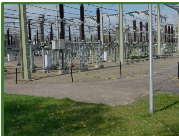
Overzicht terrein hoogspanningsstation
