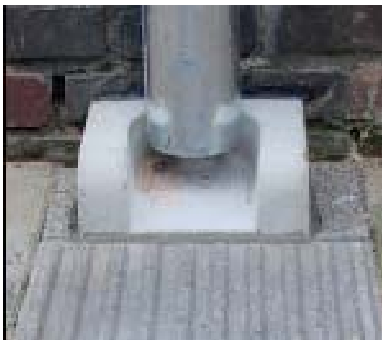
Figuur 8: regenpijp eindigend boven de grond
