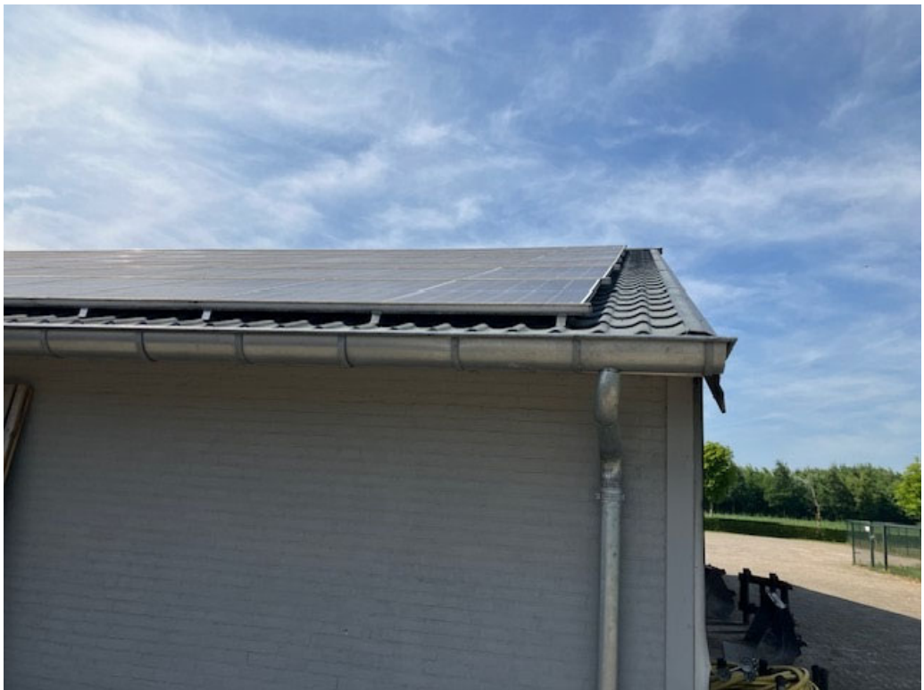
• Afbeelding 11: Zonnepanelen op het dak
