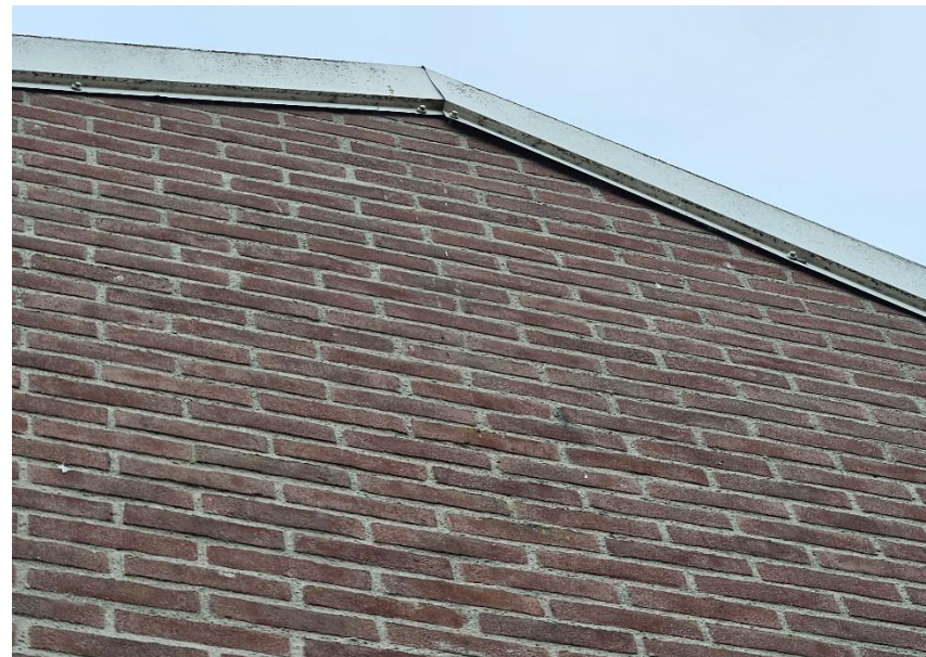
Figuur 24: kierende dakrand loods Stokkelen 5
