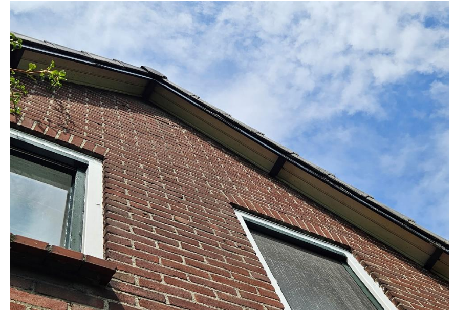
Figuur 26: overhellende dakpannen kopgevel woning Stokkelen 3
