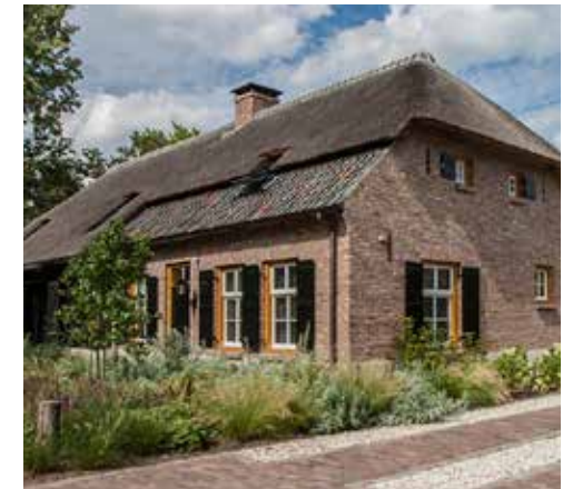
Pannen ter plaatse van het woonhuis
