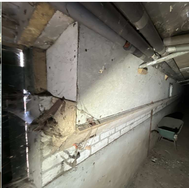
Stal 1, gangpad, vlakke platen luchtinlaat kanaal
