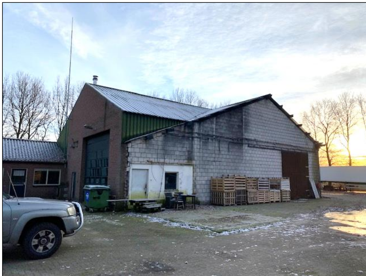
Afbeelding 24 Overzichtsfoto resterende loods na brand
