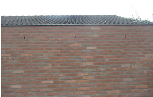
Figuur 9. Stootvoegen in aangrenzende bebouwing.
