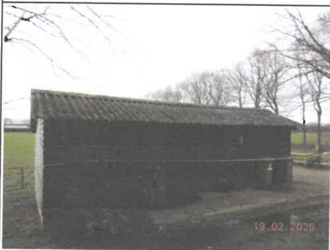
Foto 4: Asbestverdacht dak buiten het lint en buiten de opdracht.
