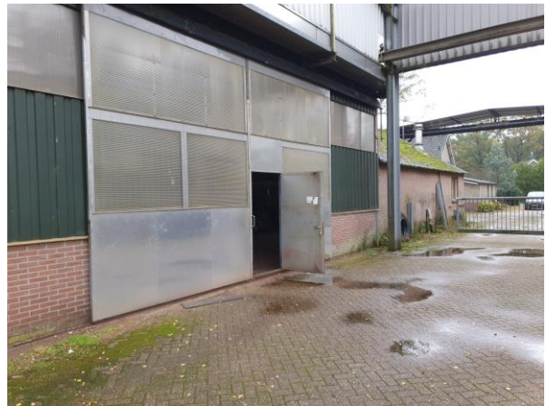
Ander gevel van de damwand loods. De loodsen zijn goed afgesloten en niet toegankelijk via grote kieren en/of gaten.
