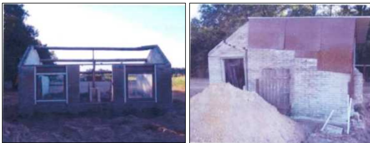
Figuur 27: Beelden van de staat waarin de schuren in de huidige situatie verkeren
