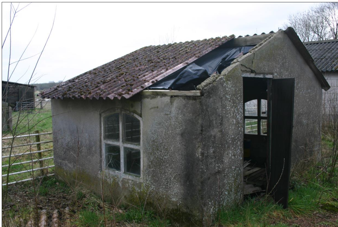
Figuur 3.1.2. Een klein, enkelwandig vervallen schuurtje.
